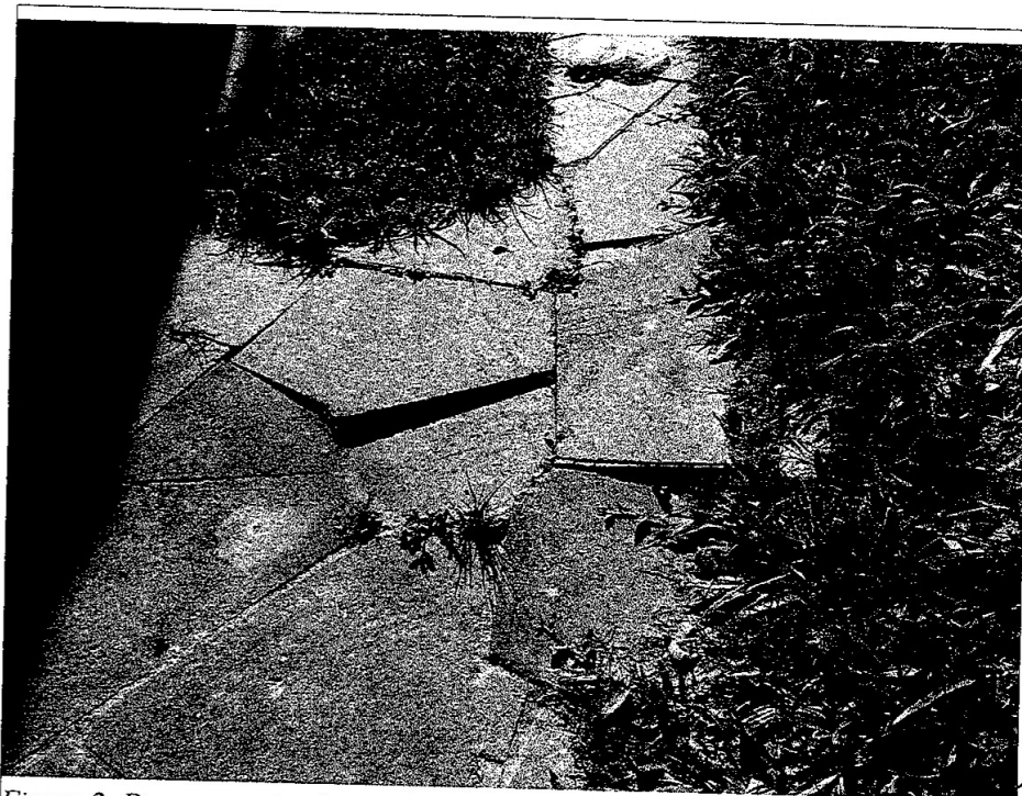
Figura 2: Danos na calçada.
